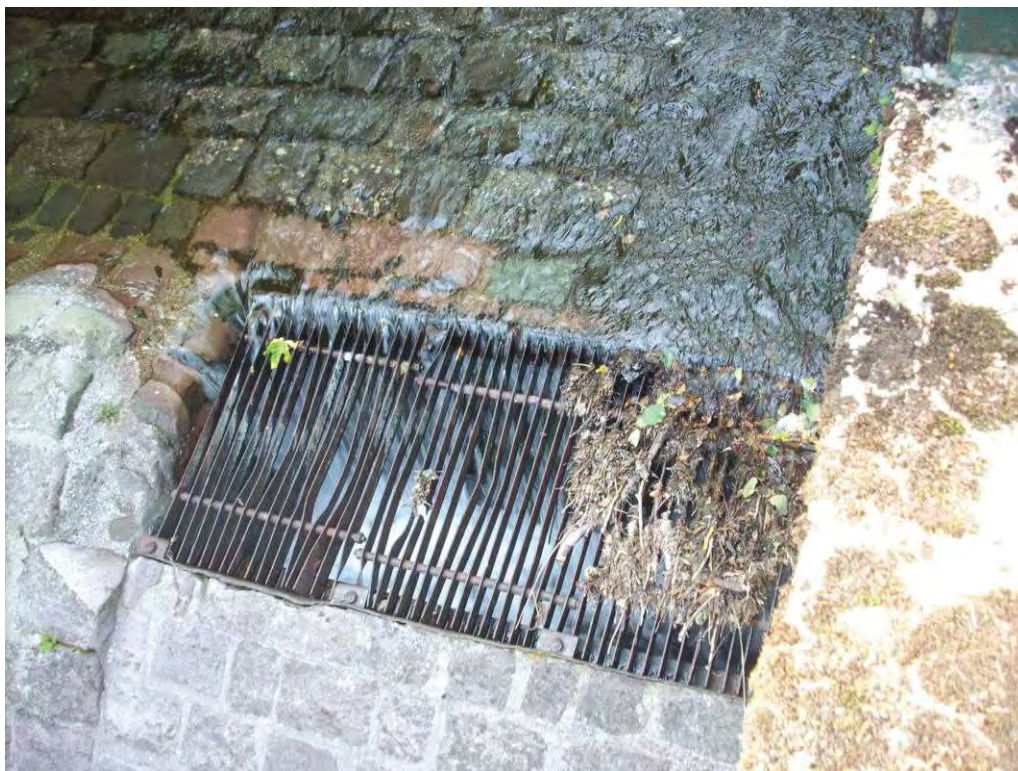
VISTA 9 – GRIGLIA METALLICA DI PRESA ACQUE
